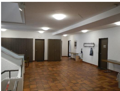
Abbildung 31: Energieeffiziente Beleuchtung mit Bewegungsmeldern
