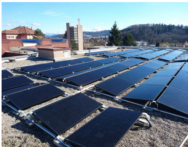
Abbildung 18: PV Anlage auf dem ÖKZI
